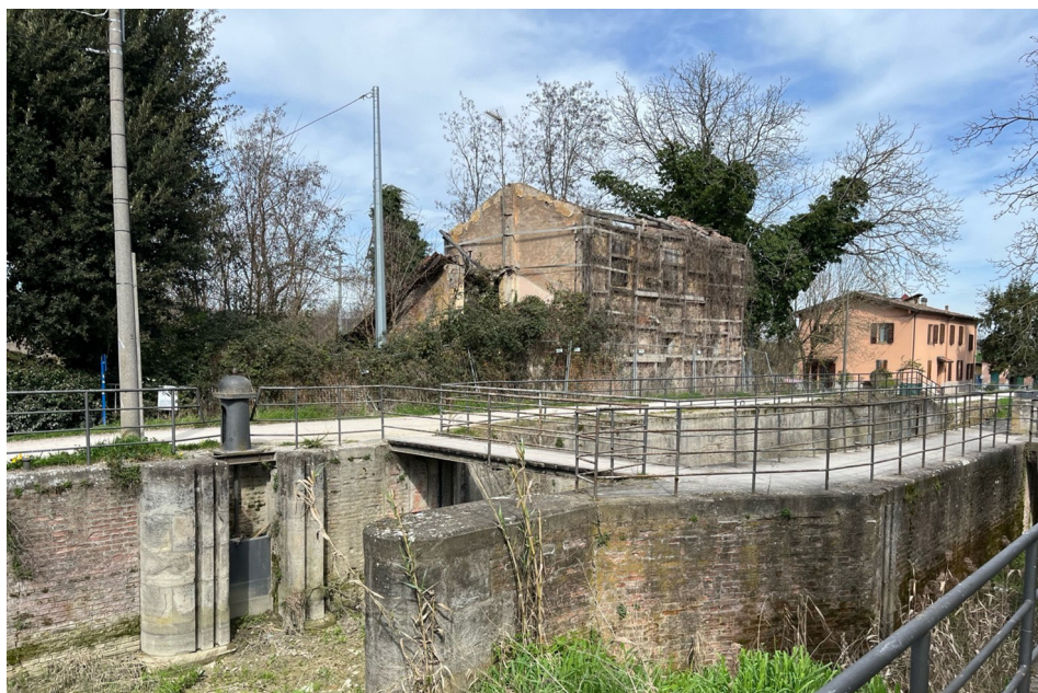
Fig. 4. Il sostegno del Torregiani, altro manufatto idraulico che serviva alla navigazione, abbandonato dagli anni Sessanta e in rovina. Si nota la conca di navigazione completamente priva d'acqua.
